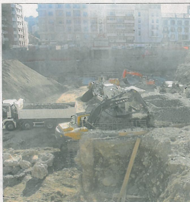
Ce cliché rend compte de la profondeur du trou. Au premier plan, les engins travaillent à l'opération de concassage des pierres sur le site. Photo DLV.B-G
